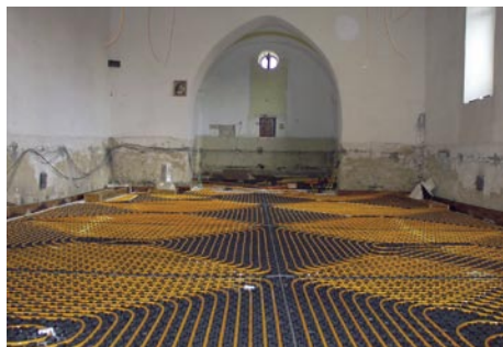
Veriacich zohrievajú takmer dva kilometre rúr, skrytých pod podlahou kostola. Teplú vodu do nich dodáva tepelné čerpadlo Buderus so systémom zem/voda – teplo sa odoberá z okolitej zeme a dodáva vykurovacej vode.
