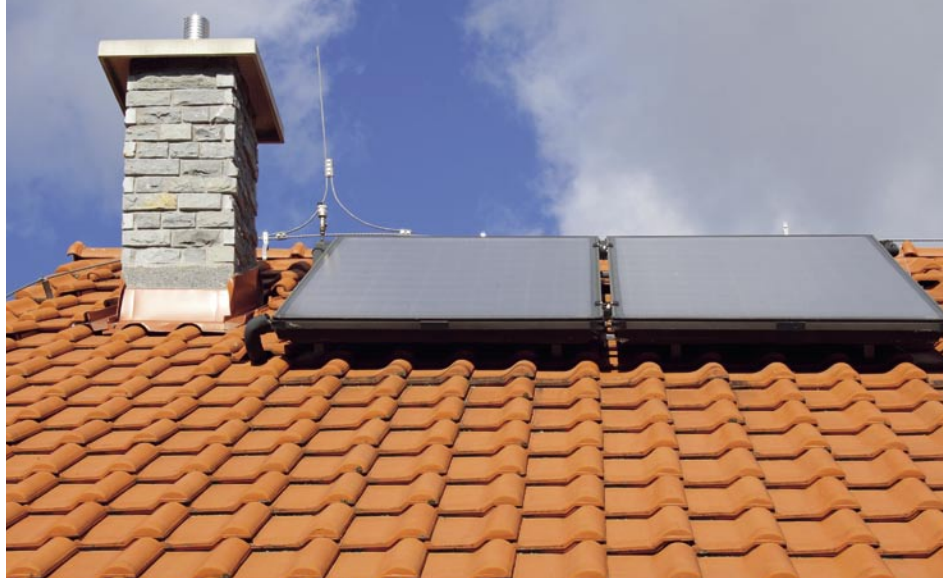
Okrem výroby elektriny na fare v Novej Lesnej ohrieva slnko aj vodu. Plynový kondenzačný kotol doplnil solárny systém. Kotol, solárne panely aj riadiaca jednotka je od značky Buderus.
