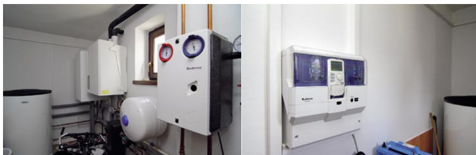
So solárnym systémom sa nepočítalo od začiatku, projektant musel zasiahnuť do toho, čo bolo dané, preto je systém na ohrev teplej vody a vykurovanie pomerne zložitý. Slnkom sa v prvom rade ohrieva voda v stolitrovom zásobníku pitnej vody, až potom je na rade podpora kúrenia – predhrev vody v druhom zásobníku. Ikonka na displeji vždy znázorňuje, keď sa používa slnkom ohriata voda na kúrenie.
